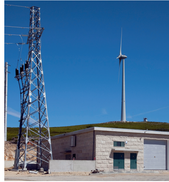
توصيل طاقة الرياح الصديقة للبيئة بالشبكة عن طريق القاطع الكهربائي المعزول بالغاز صغير الحجم من سلسلة المنتجات 8DN8 في مبنى القاطع الكهربائي
